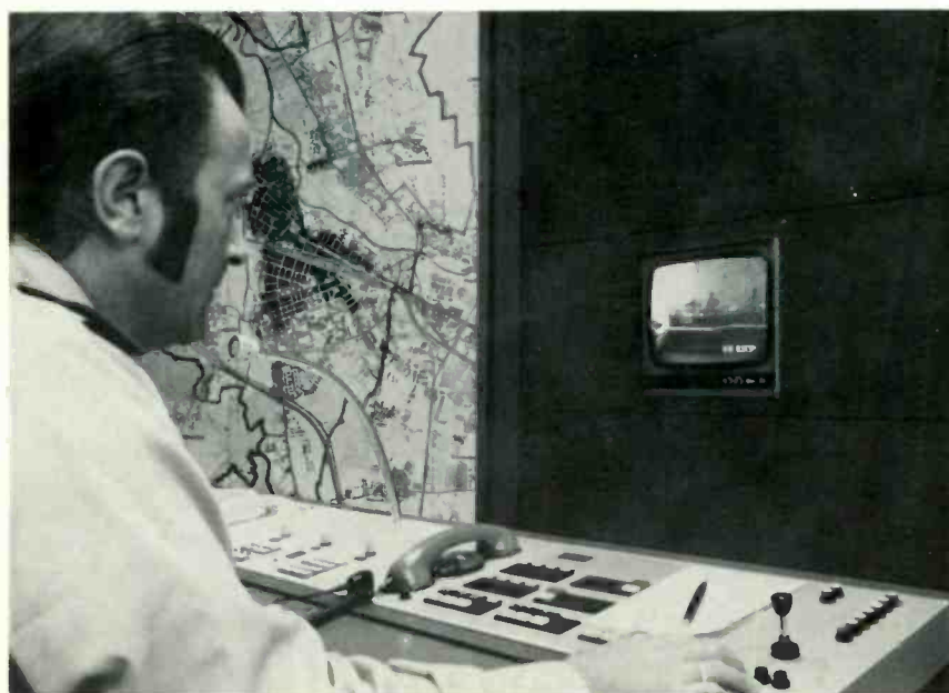
Bild 2 Bedienpult mit Monitor in der Funkleitzentrale
