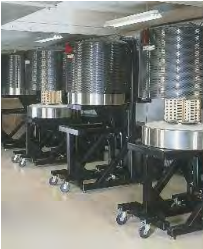
Frittage - Fours cloches
