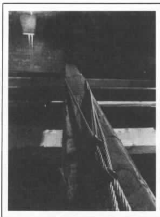
Détail du câblage au centre de la poutre
