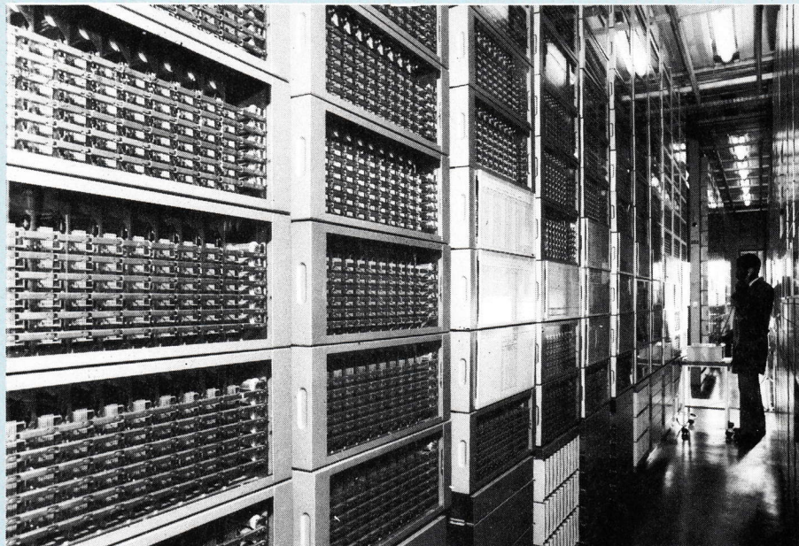
10. Système Crossbar CP 400. (Photo Thomson CSF).
