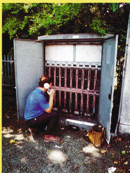
1. Technicien dans un sous-répartiteur (DRT Toulouse).
