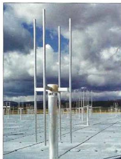
4 - Détail d'un des groupements d'antennes de réception.
