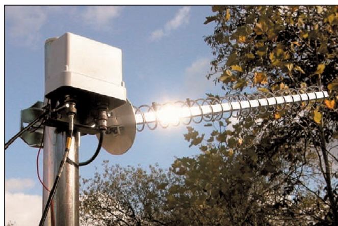
L'antenne n'est qu'à 1,5 m du sol.
