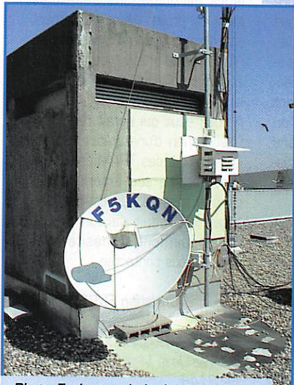
Photo 7 - La parabole de réception Meteosat et la station de mesures météo.
