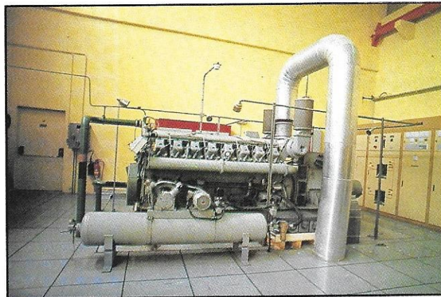
L'un des groupes de secours.
