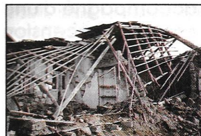
Spitak : les ruines sont encore très présentes 2 ans après le séisme.
