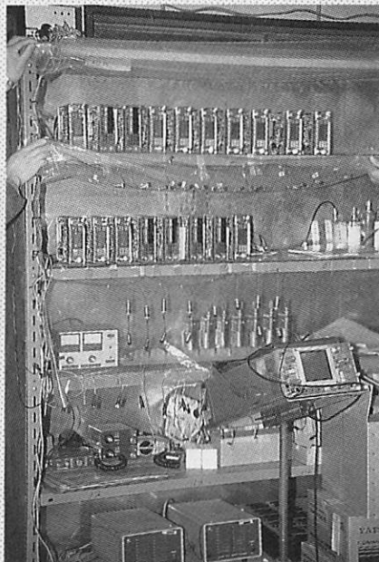
Armoire de mise en chauffe
