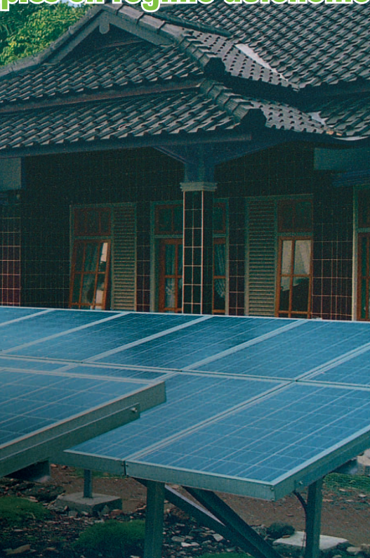
Les installations autonomes solaires jouent avant tout un rôle important dans les zones où l'électrification est peu développée. Système autonome 4,2 kW en Indonésie (photo : Schott Solar GmbH).
