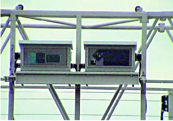
Font déjà partie de la vie quotidienne sur l'autoroute : ponts de contrôle avec détecteurs destinés à saisir les données de péage. (Cliché : Toll Collect)
