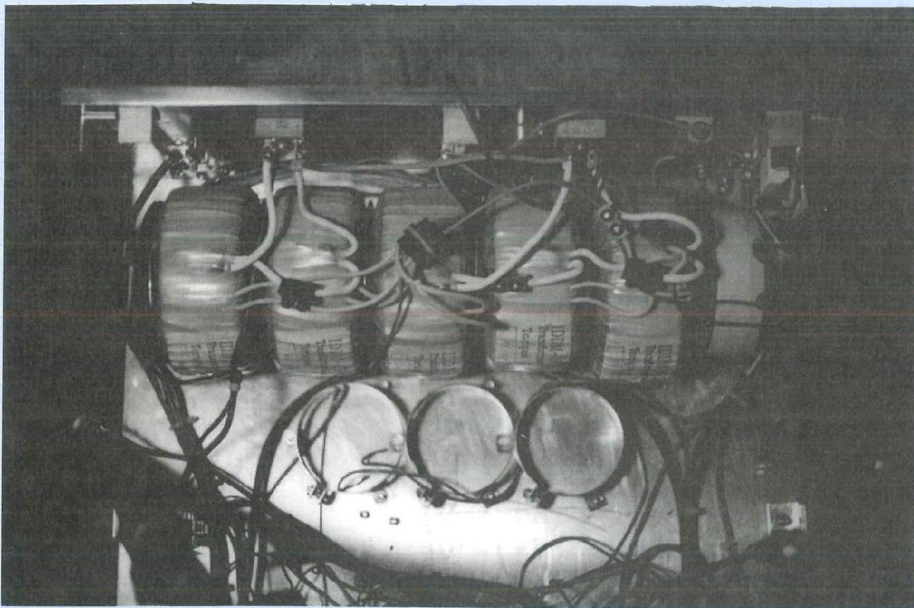
Photo 3 : vue intérieure de la face arrière
