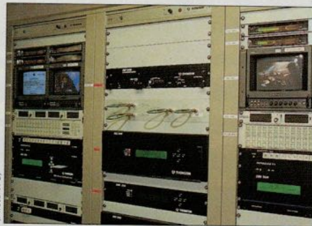
Au centre : les deux multiplexeurs (Thomson), l'un fonctionne en secours, l'autre en diffusion.
