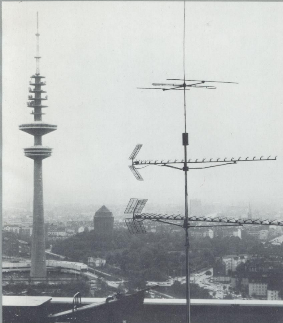
Die große Gemeinschafts-Antennenanlage von Philips in 106 Meter Höhe auf dem Dach des neuen Hotels „Loews Hamburg Plaza“. Sie versorgt das 1100-Betten-Hotel optimal mit allen Fernseh- und Rundfunkprogrammen.
